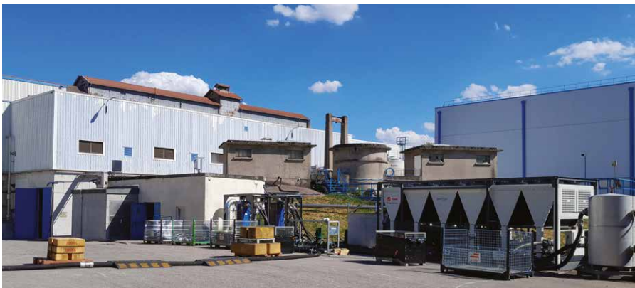
Papeteries de Clairefontaine - Groupe froid et échangeurs de chaleur
