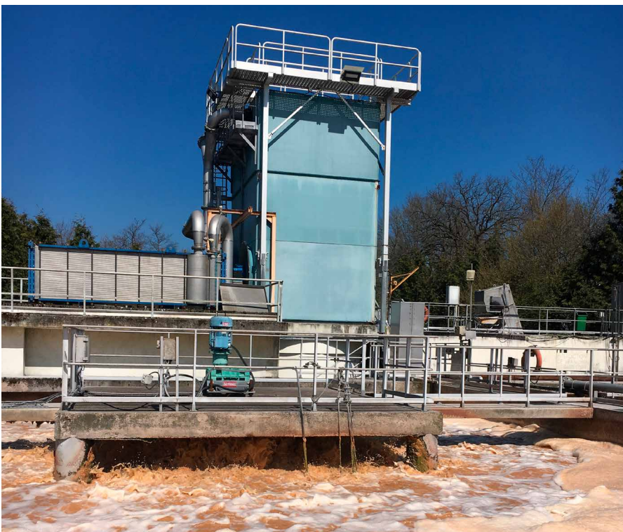
Aperçu de la station d'épuration des Papeteries de Clairefontaine
