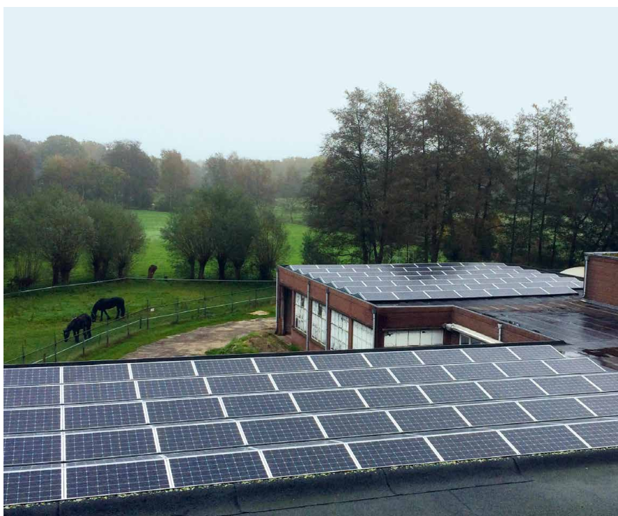
Panneaux photovoltaïques - SCHUT PAPIER (Pays-Bas)
